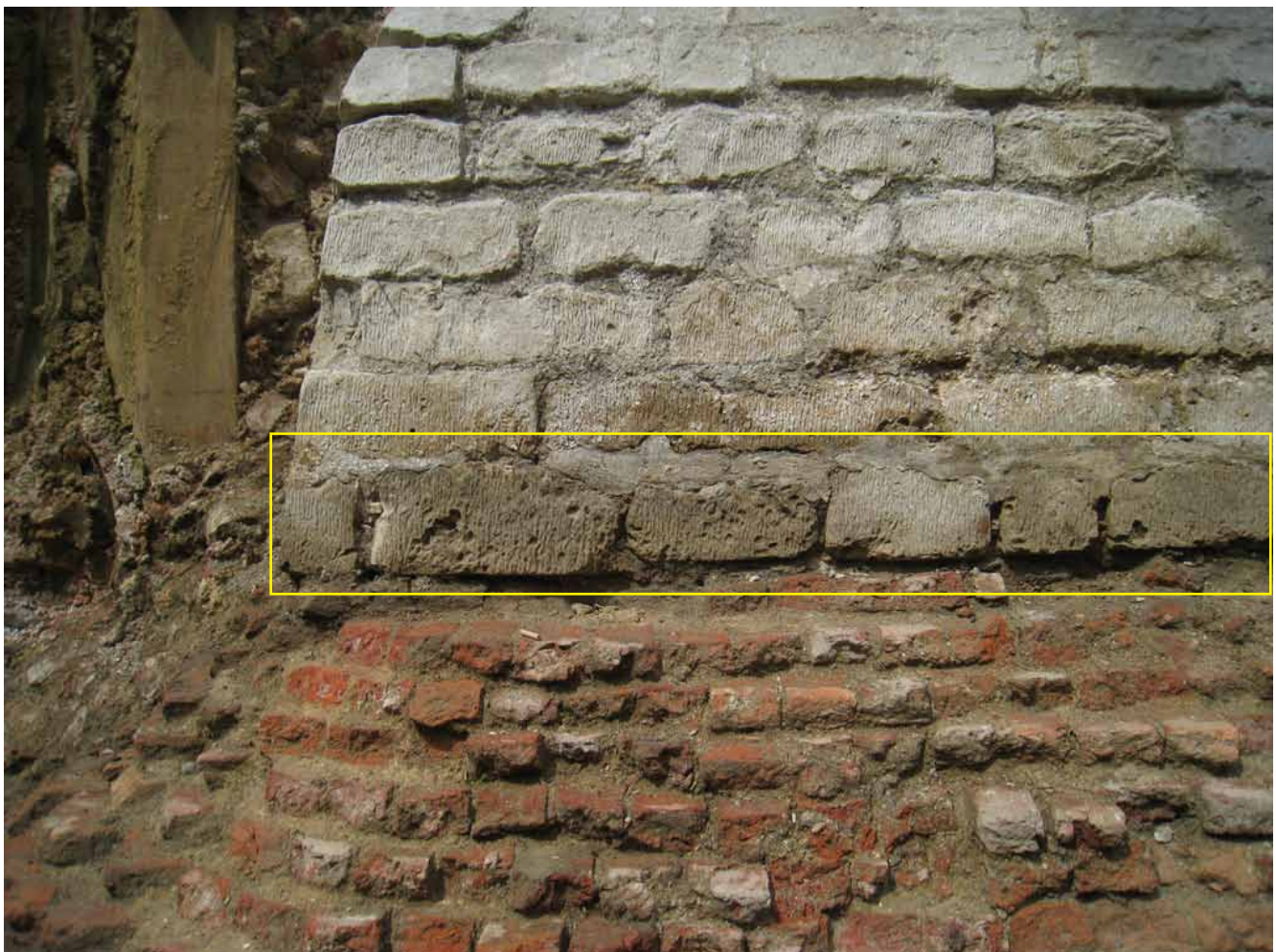
Fig. 25. Ter hoogte van de bastionhoek, boven de bakstenen fundering, begint de opbouw van het parement in Ledesteen. De onderste rij vertoont opvallende schade veroorzaakt door botanische of biologische aantasting.
