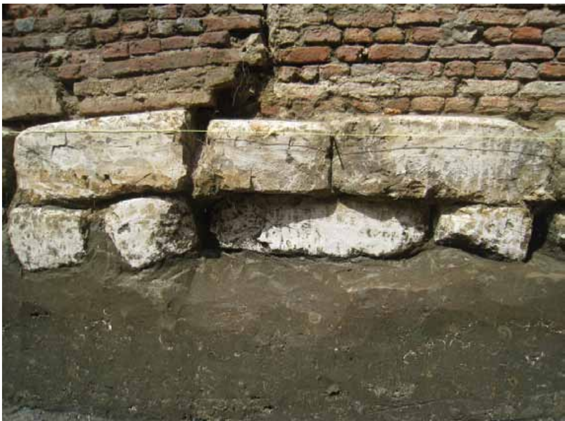
Fig. 9. Zetting in onderliggend glauconietrijk zand, face 1. Het breken van de krijtsteen en het scheuren van het baksteenmetselwerk is hiervan het gevolg.
