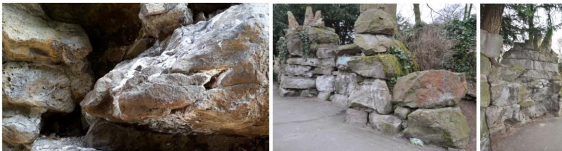
Foto's beschadigde rotsselementen, losse en ontbrekende stenen, barstvorming.
