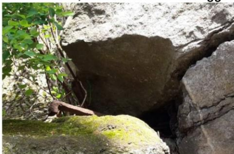
Foto's verankering zijn doorgeroest en komen soms in zicht te liggen.
