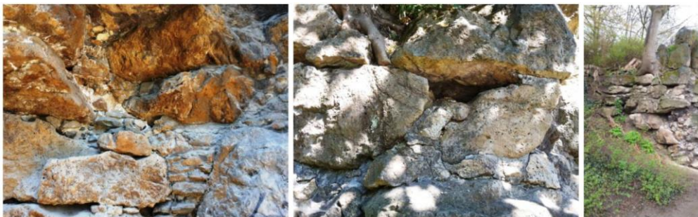
Foto's beschadigde voegen, erosie en wortels in de voegen, grondverschuiving.
