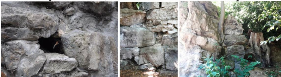
Foto's holtes, ontbrekende en losliggende stenen, zetting stenen.
