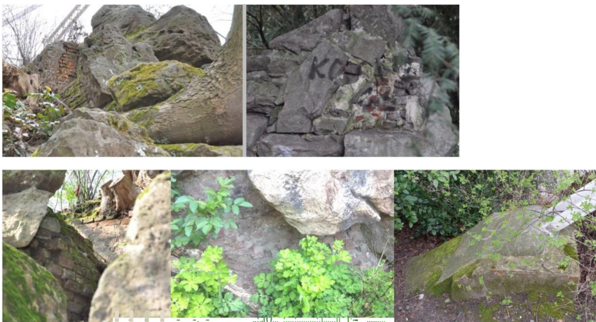
Foto's vrijgekomen en beschadigd metselwerk van de brughoofden.
