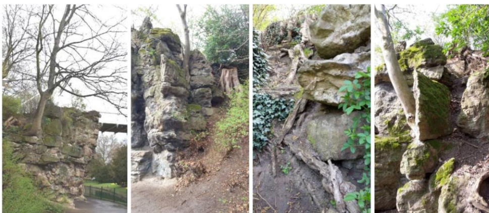
Foto's schade door wildgroei, aantasting van voegen en rotselementen.
