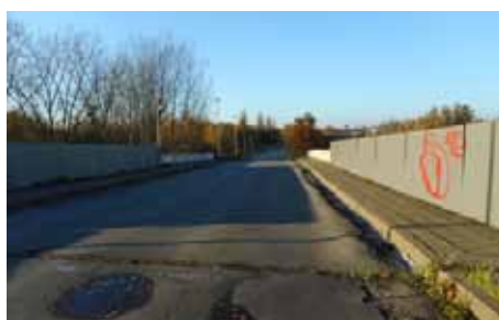
slechte staat van het wegdek van de brug
