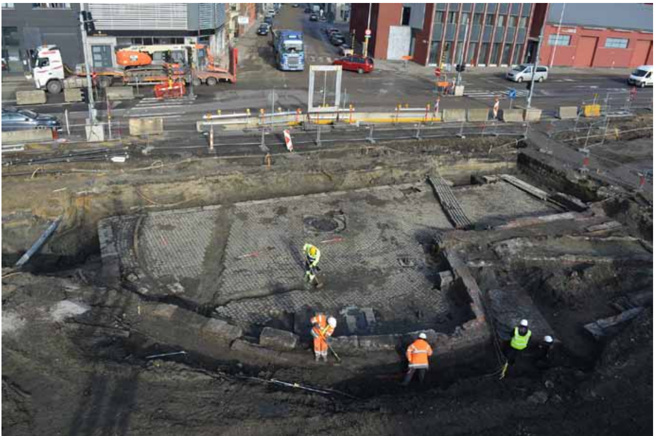
Figuur 1. Het platform van de draaibrug ter hoogte van de Bredastraat (zuidzijde IJzerlaan)
