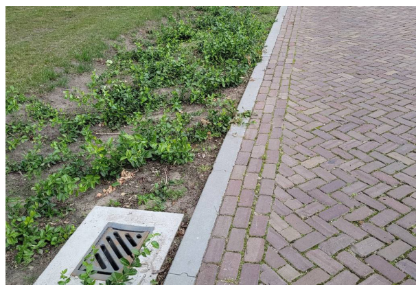
Afwatering naar een verdiepte plantvak met overstort riolering
