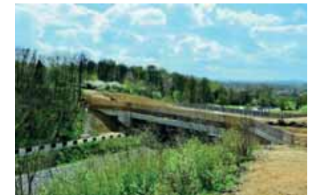
— Opbouw van een ecoduct van middelgrote schaal over de A2 in Maastricht
