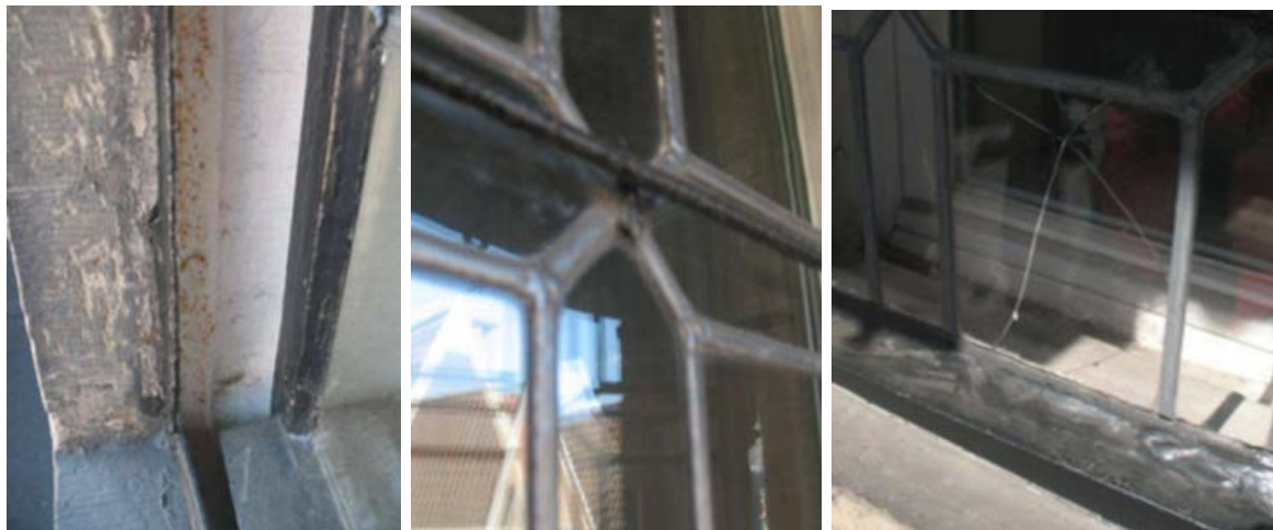
Afbeelding 40: de stalen ramen op de 2e verdieping zijn licht roestig (foto Origin)
