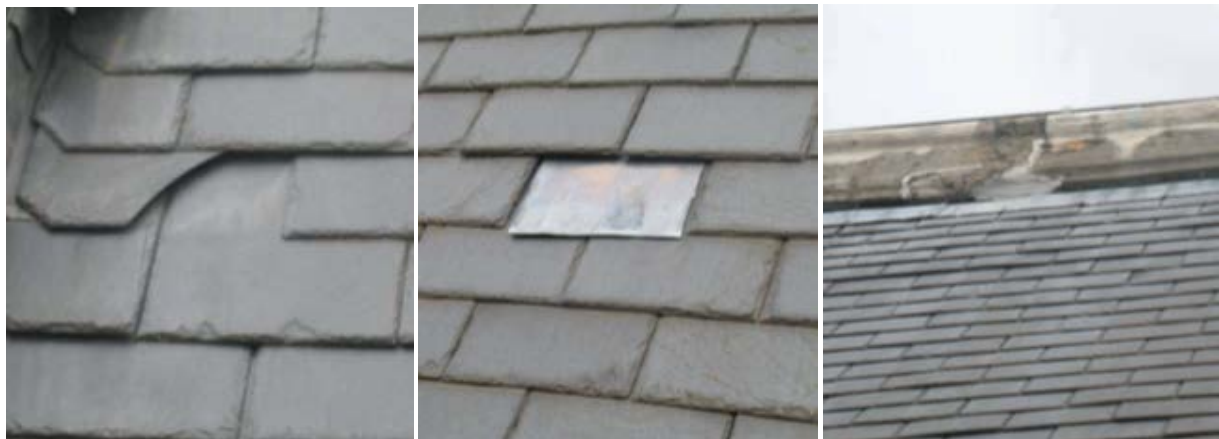
Afbeelding 66: plaatselijk zijn er een paar leien gebroken (foto Origin)
