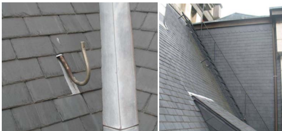
Afbeelding 97: detail van een ladderhaak. De ladderhaken voldoen niet aan de Europese norm EN 517 (foto Origin)
