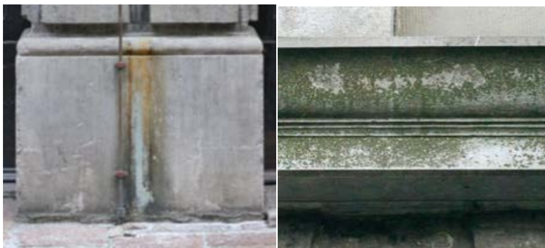
Afbeelding 19: corrosie van de bliksemafleider
