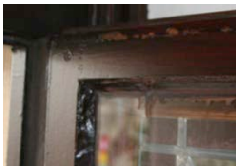
Afbeelding 37: plaatselijk is de afwerklaag op het schrijnwerk wat verschaald en is de stopverf verduurd.
