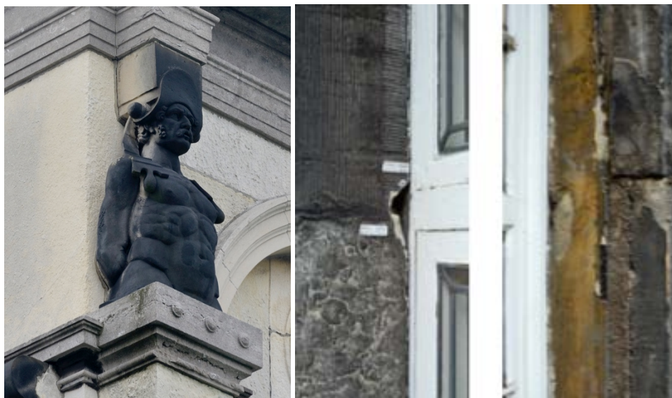
Afbeelding 15 & Afbeelding 16: vervuilde Bentheimer standbeelden en verwerking van de binnenkoergevels met gipskorsten en afschilfering
