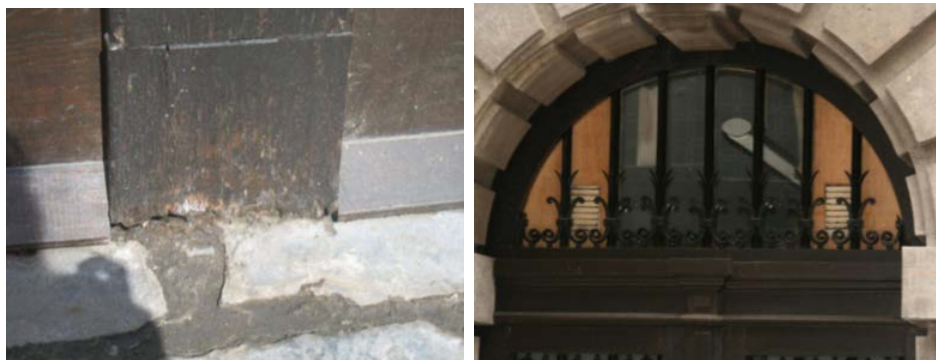
Afbeelding 43: zicht op een ingeroote deurstijl aan de westgevel
