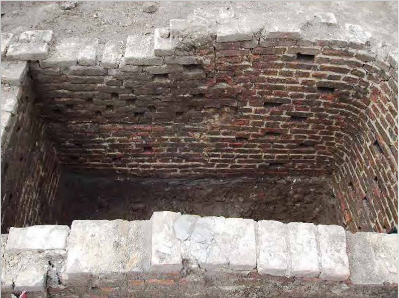
Figuur 24. Drainageput S43
